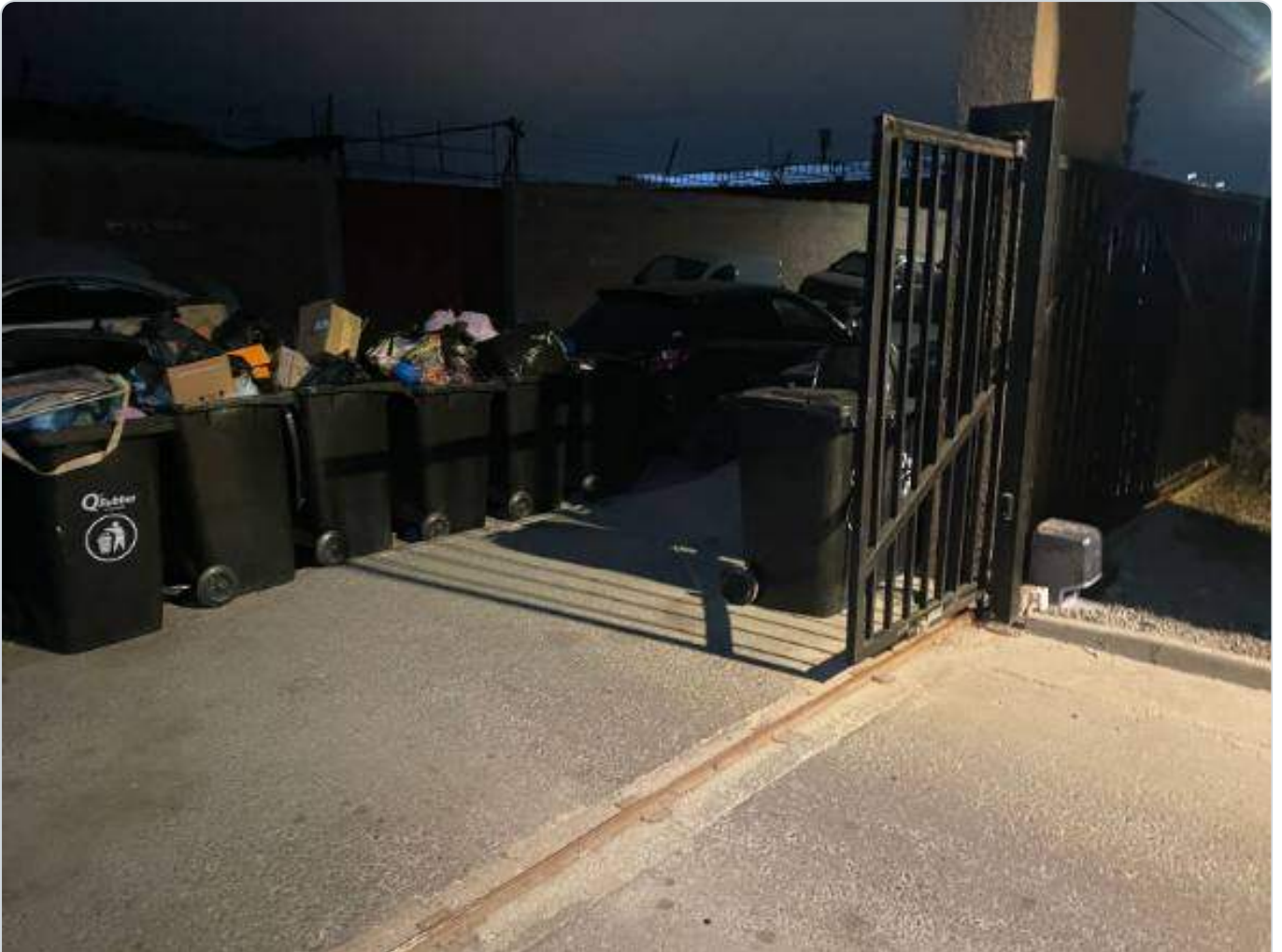
Equipo / Motor Portón Salida Iglesia de la Merced queda operativo con velocidad baja
