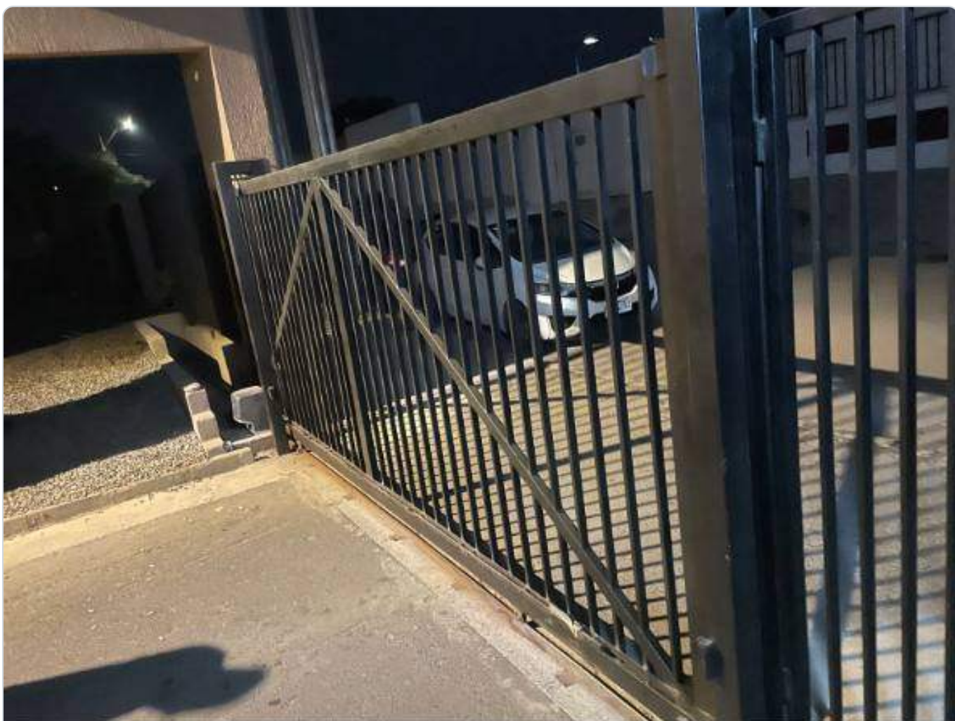
Equipo / Motor Portón Ingreso Iglesia de la Merced Queda operativo equipo con velocidad lenta
