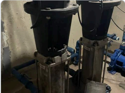
Equipo / Hidropack Bombas de Parinas en sala de bombas
