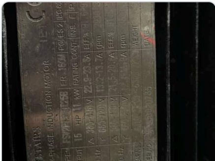
Parte / Bomba Placa motor bomba de Parinas
