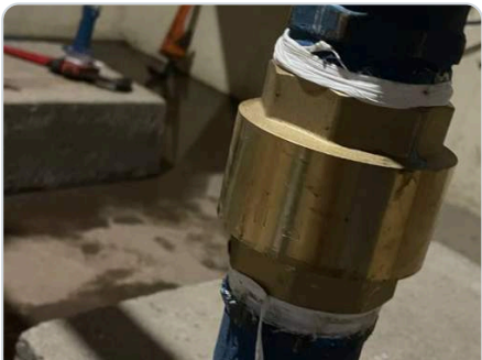
Pieza / Bomba 2 Válvula check salida bomba 2 no retiene presión; cambiar
