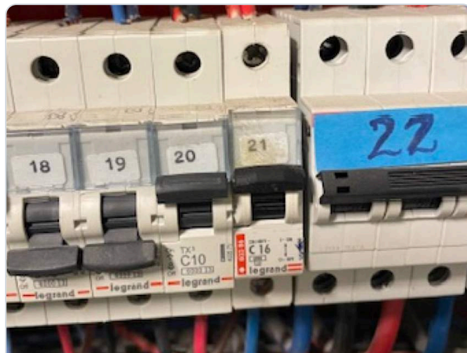
Equipo / Generador interruptor 21 corresponde a la bomba de la piscina que esta con el tablero dañado en sector piscina
