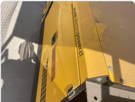
Equipo / Generador estado
