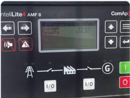
Equipo / Generador horometro
